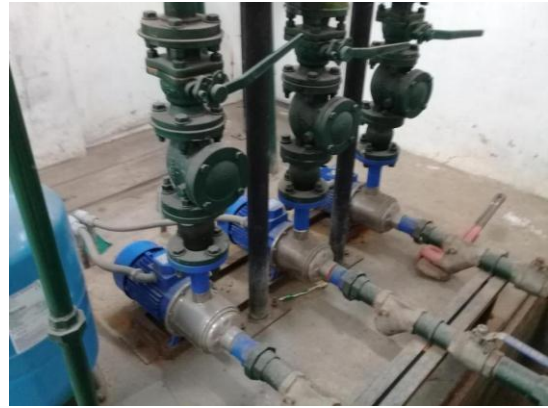
Vista del sistema de bombeo del agua potable. 02 electrobombas y el tanque hidroneumático no funcionan
