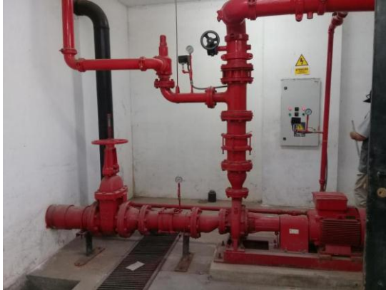
Vista del sistema de bombeo contraincendios inoperativo en caseta subterránea de bombas
